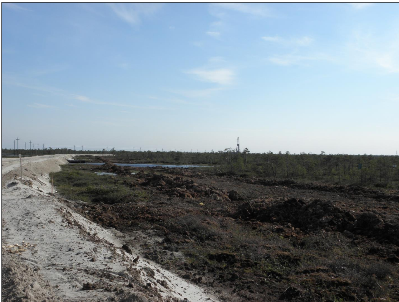
Рисунок 3. Дорога, нарушения придорожной зоны.
